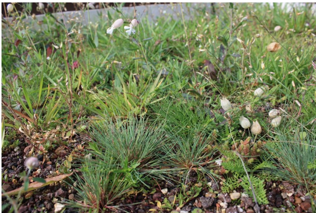
Abb. 2: Experiment zur Eignung gebietsheimischer Wildpflanzen für die extensive Dachbegrünung: Vegetationsentwicklung mit Silbergras, Hasenklees und Taubenkropf-Leimkraut sechs Monate nach Aussaat (Foto: V. Straub)
