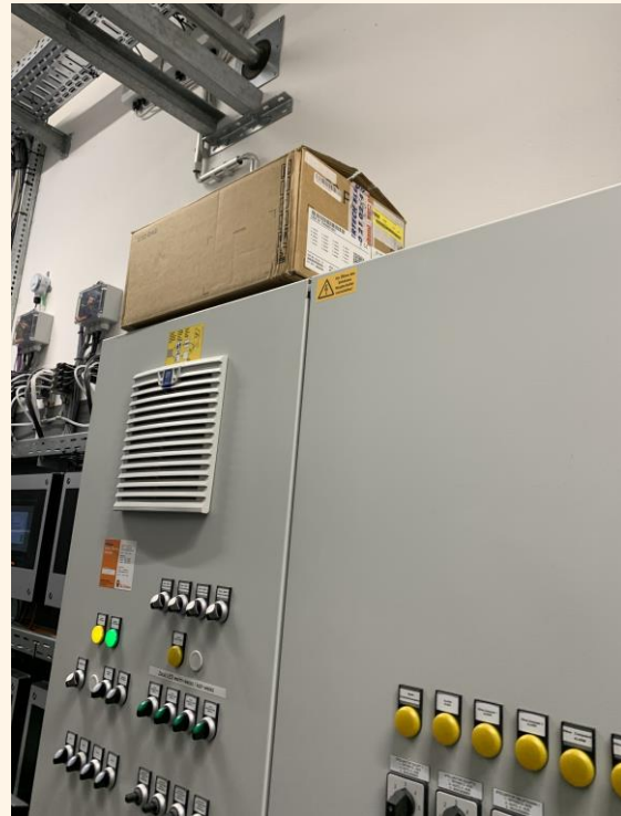
Kartonablage auf Stromverteiler
